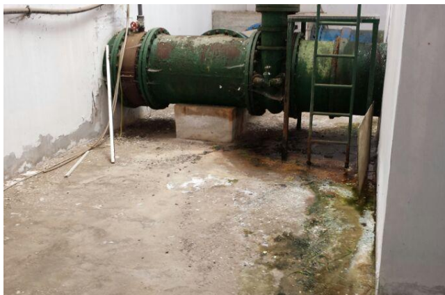
F.3 Condotta che arriva da "Galleria Ciapparazzo"
