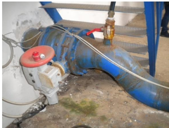
F.4 Condotta che va verso i serbatoi Adrano bassa Valvola esistente motorizzata e telecomandata
